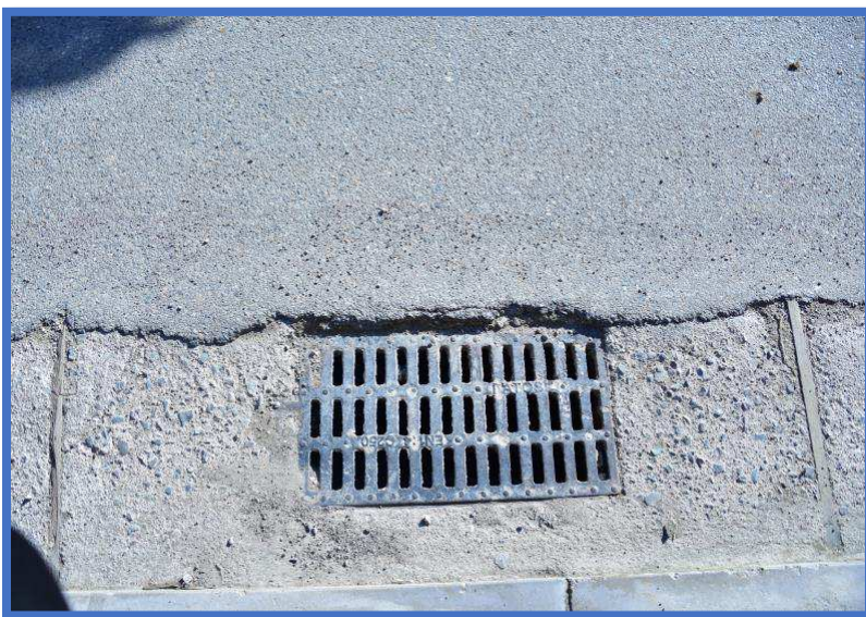
Fig. 1 Shtrim i shtresave asfaltike ne menyre jo te njetrajtshme
