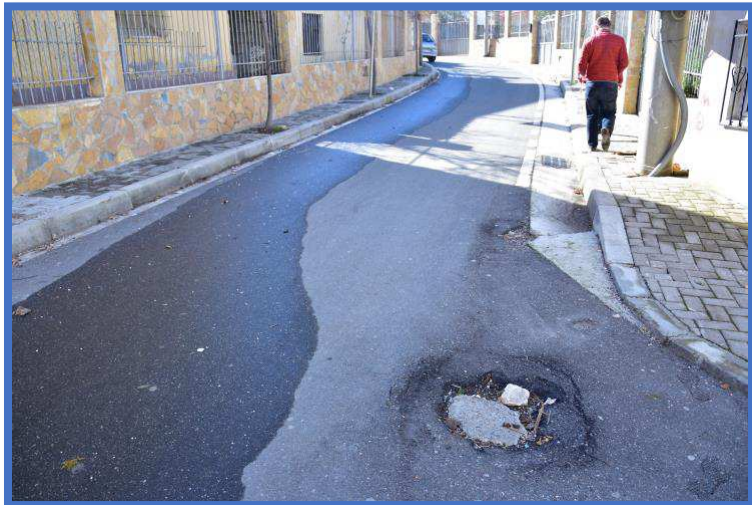
Fig. 2 Dëmtim i shtresave asfaltike
