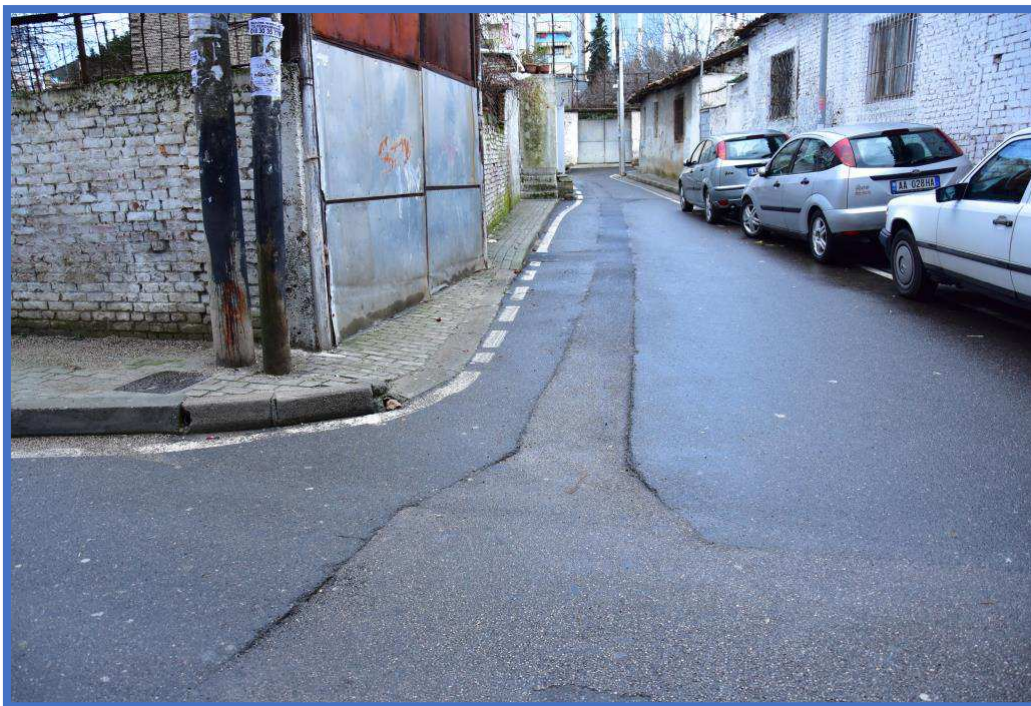
Fig. 1 Shtresa asfaltike te demtuara vetem pak muaj pas kryerjes se investimit, nderhyrje e cila ka sjelle nje degradim te cilesise dhe qendryshmerise te rruges
