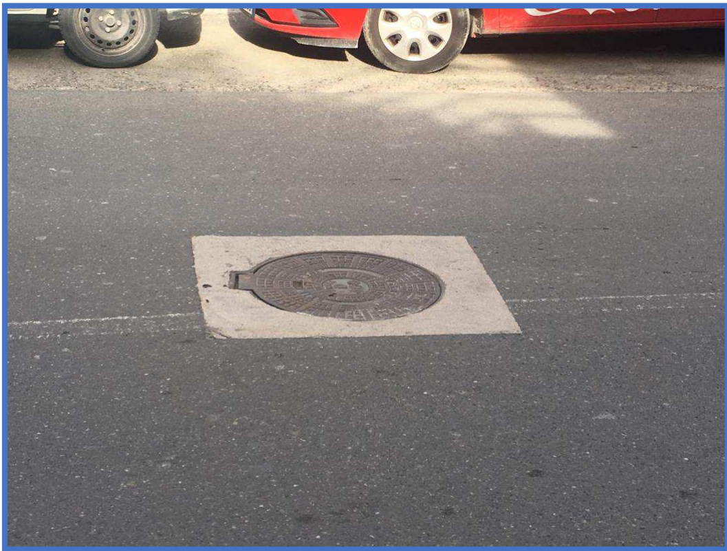
Fig 1 Pusetat janë vendosur në nivel të njëtrajtshëm me trupin e rrugës (me parete anesore të tyre të qendrueshme dhe shumica prej tyre ane të pa levizshme),
